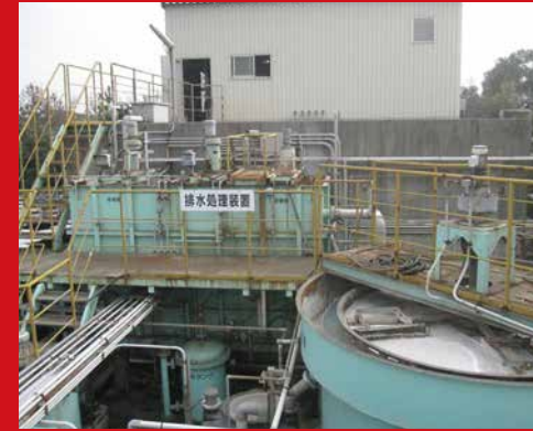
排水加圧浮上槽側
